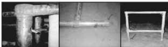
Tetones rotos en los lat.barandilla. Ausencia de casquillo inferior en los lat.barandilla. Golpes y deformaciones
