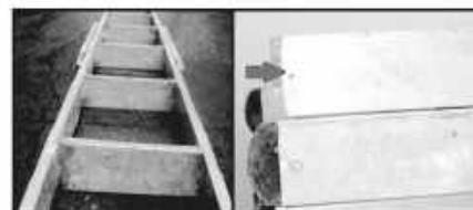
Suciedad en peldaños, Peligro de resbalar
